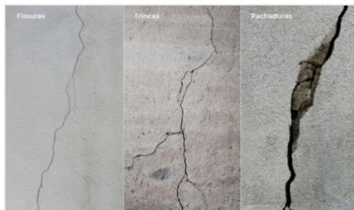
Figura 5: Fissuras, trincas e rachaduras
