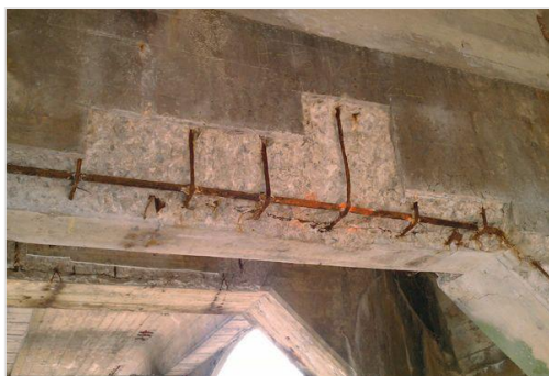
Figura 6: Deslocamento do cobrimento
