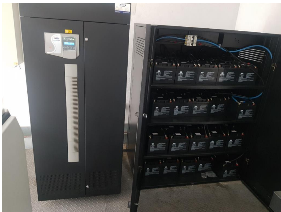
Figura 17: No-break com banco de baterias
